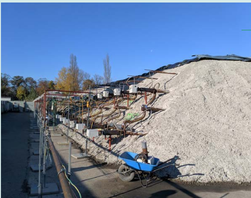
Excavation des terres à traiter et chauffage des terres polluées pour dissiper les polluants. Crédit : SPL des Deux-Rives, Strasbourg (67).
